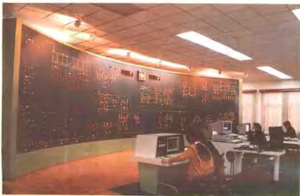
4 供电局地区 调度自动化控制 室。 (黎明强 摄)
