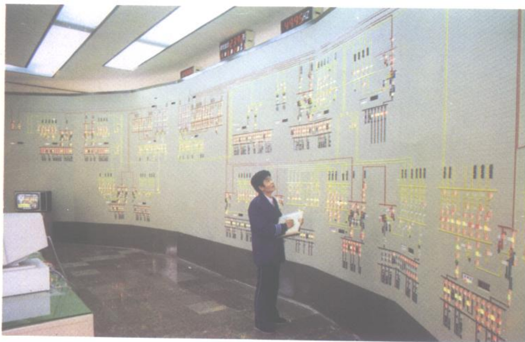
电业局调度室
