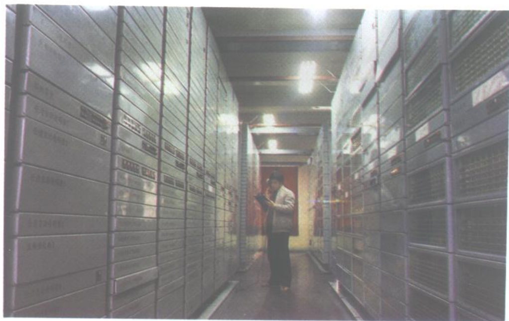
邮电局程控机房
