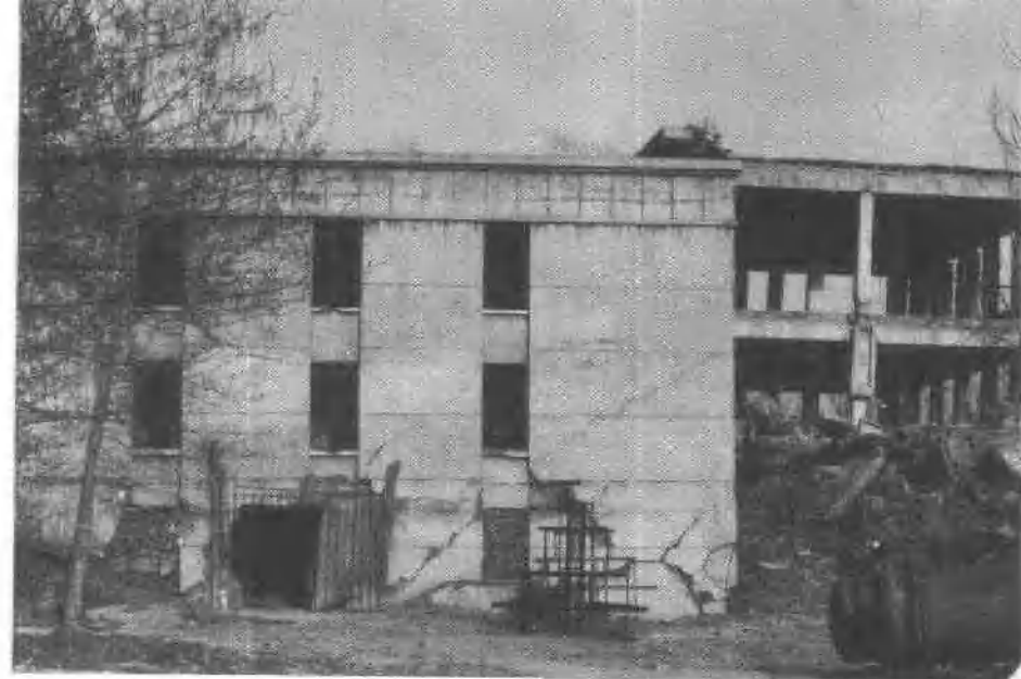
1. 此楼位于河北省工程技术学院院内,震前为四层,震后仅留三层,并发生了北西西向扭动。
