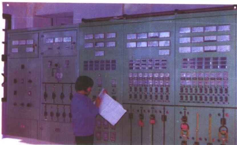
安陆电厂控制室
