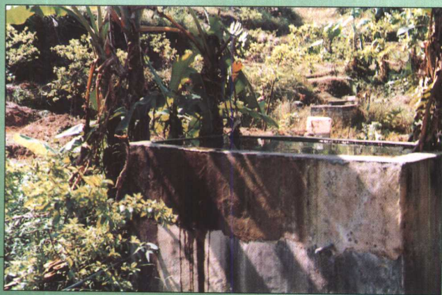
▲二级蓄水池。容积约2米 3 。上接蓄水塘，下连养殖池。池水位保持动态平衡。
