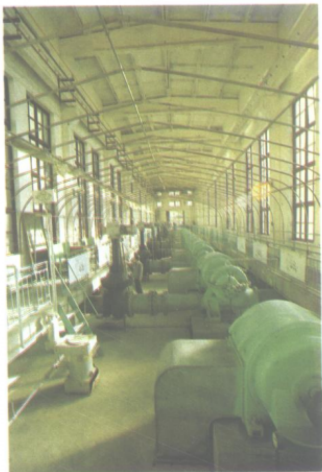
▲娘子关提引水工程一泵站
