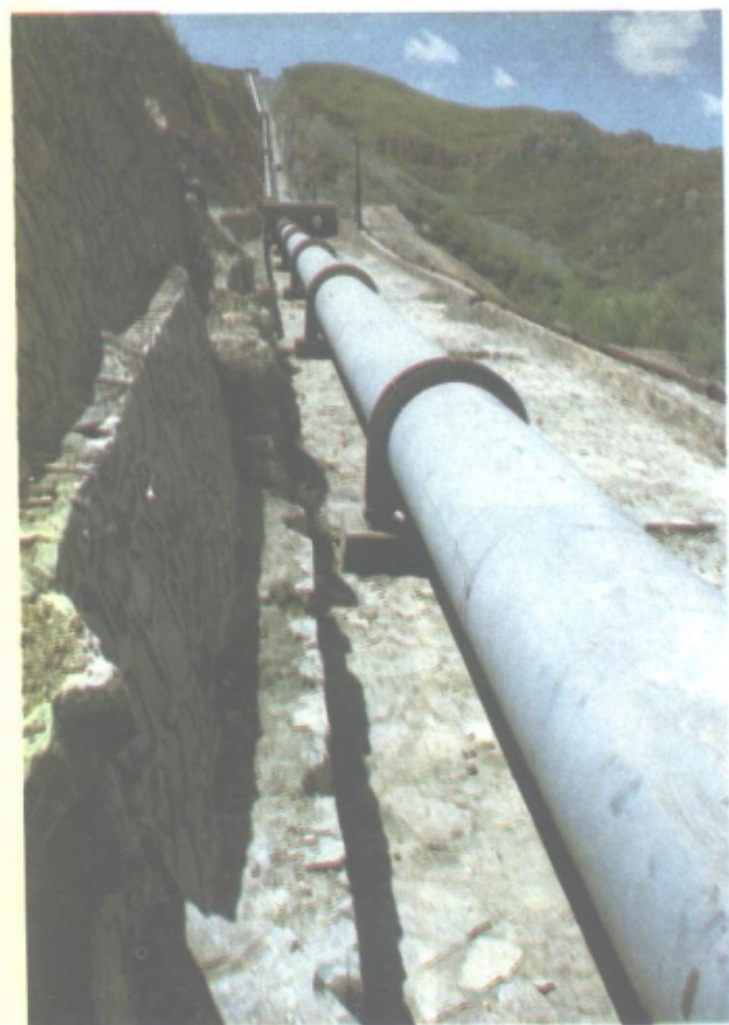
▲娘子关提引水工程管道
