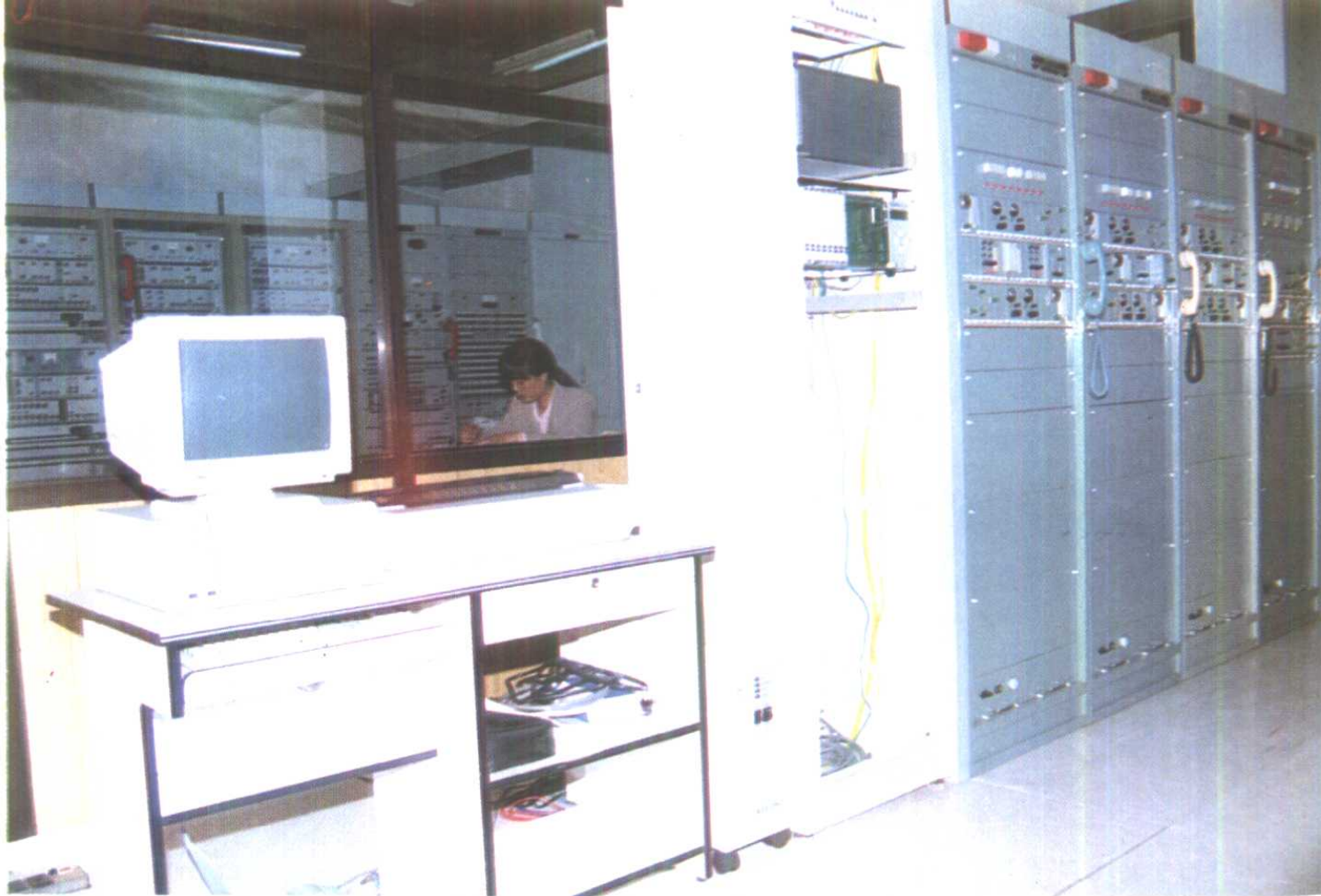
▲ 县邮电局程控机房
