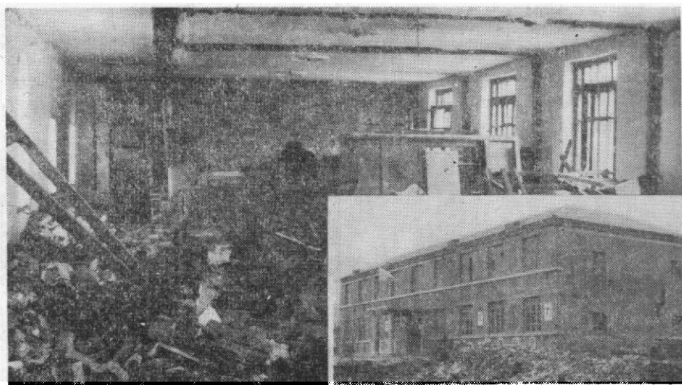
照片1.9 海城赵家堡青年楼，主体完好，土坯内隔墙和屋顶小烟囱倒塌
