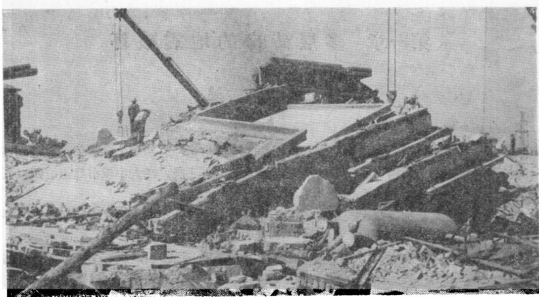
照片1.1 五层的开滦总医院门诊楼倒平
