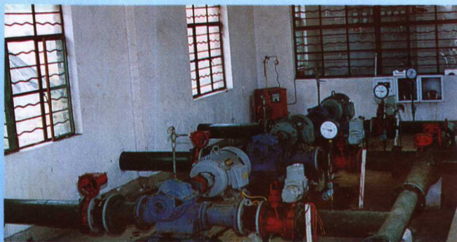
◀▼局属水处理厂的泵室
