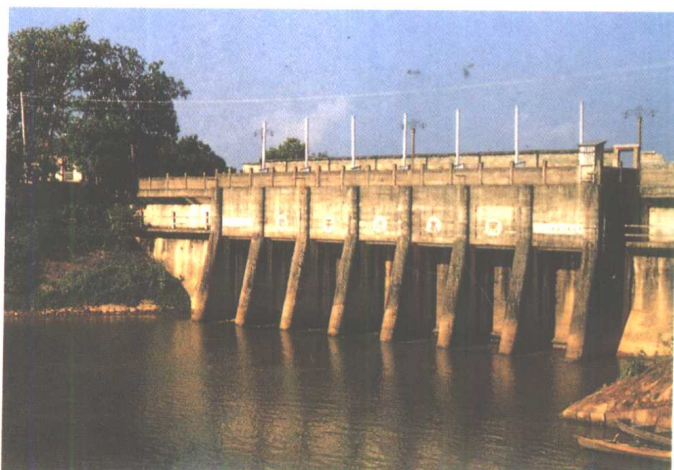
进水闸——赣抚平原水利枢纽
