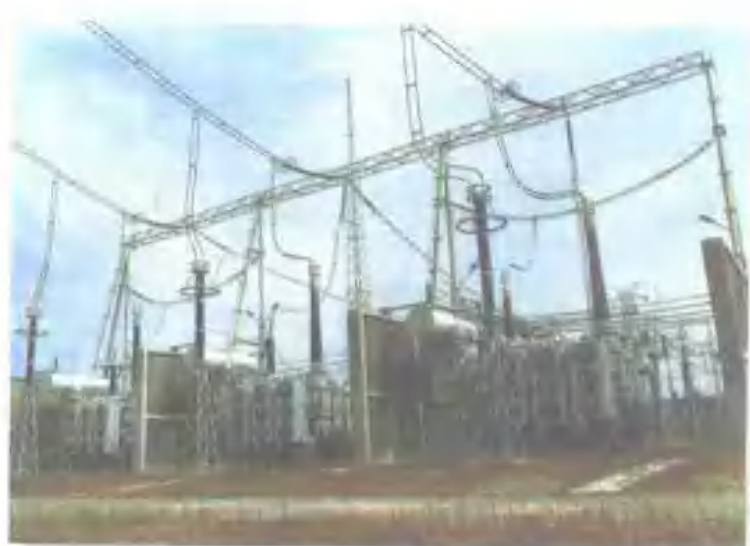
1986年建成的500千伏东丰一次变电所 3 \times 25 万千伏安主变压器
