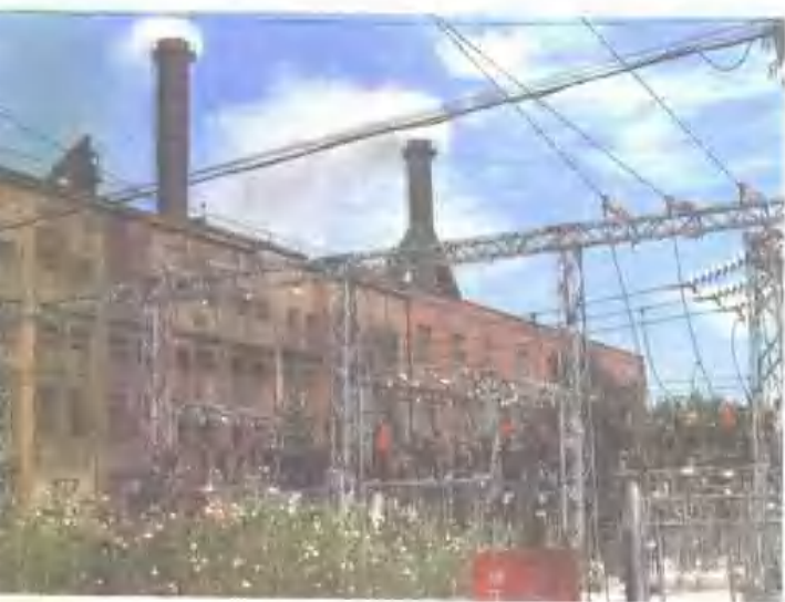
1958年扩建的辽源发电厂(装机总容量5.4万千瓦)
