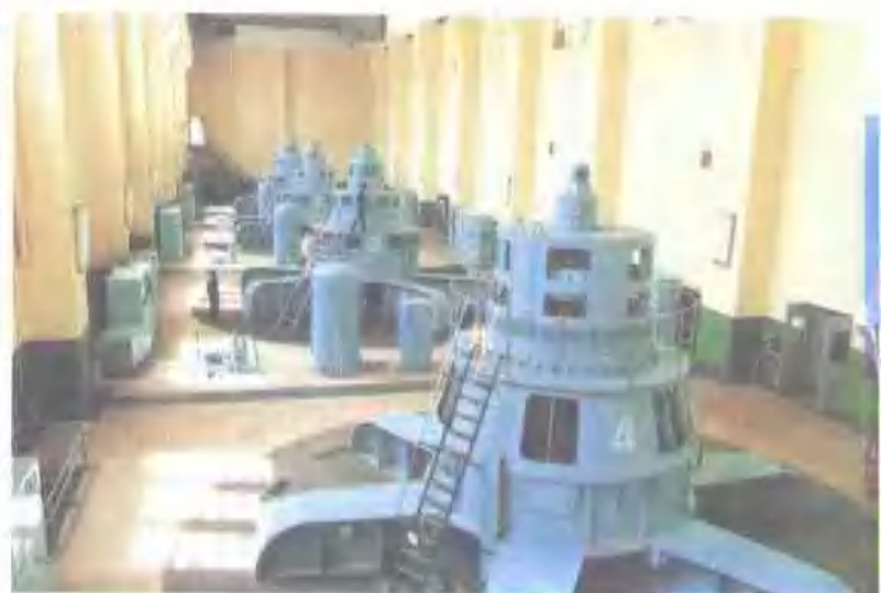
1967年建成的云峰发电厂水轮机室
