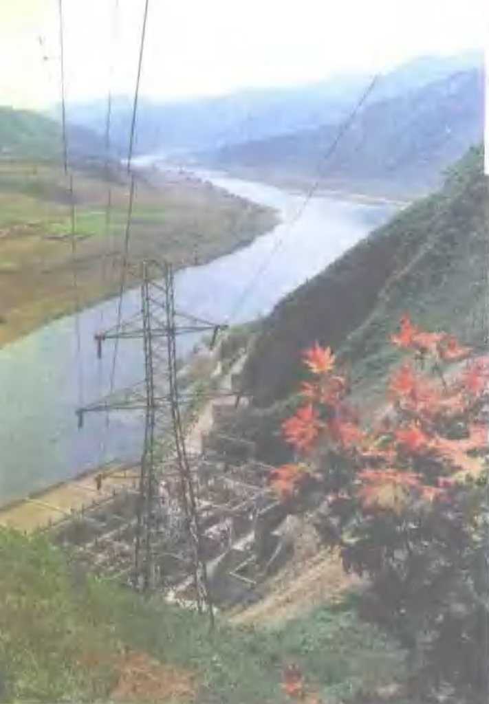
1967年建成的云峰发电厂变电所 出口塔
