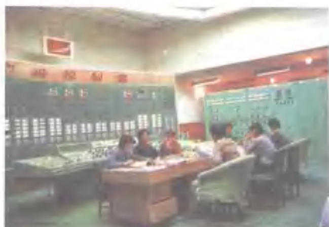
1985年白山发电厂中央控制室
