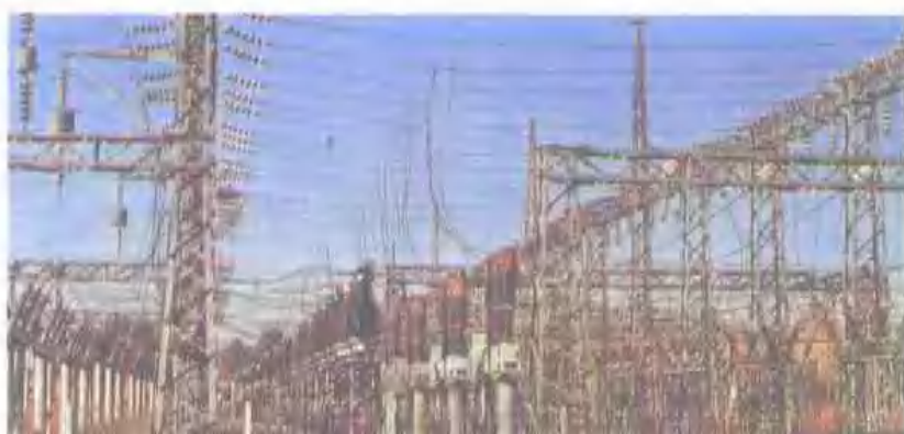
1943年建成的吉林省第一个154 (220) 千伏长春一次变电所
