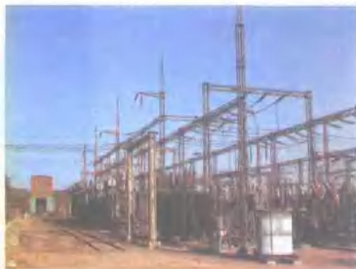
1953年新中国建立后建成的第一个154 (220) 千伏吉林一次变电所
