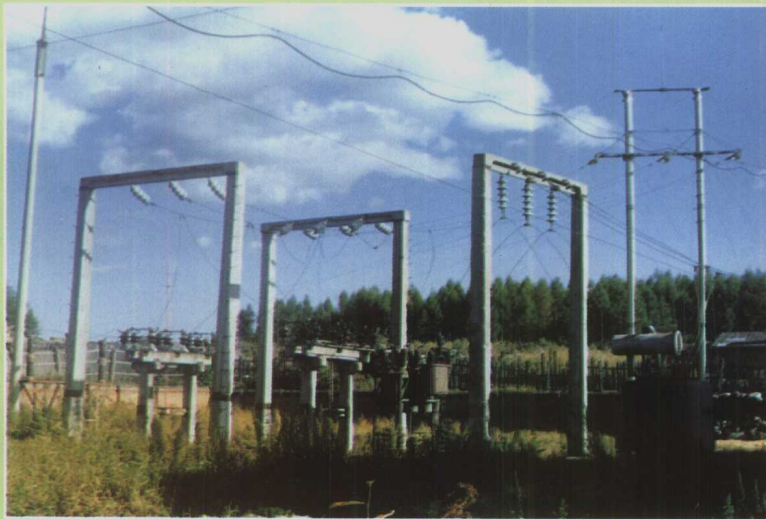
烏伊嶺變電所
