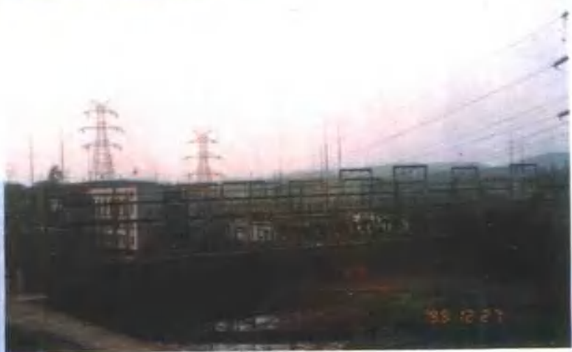
舒平 220KV 输变电站
