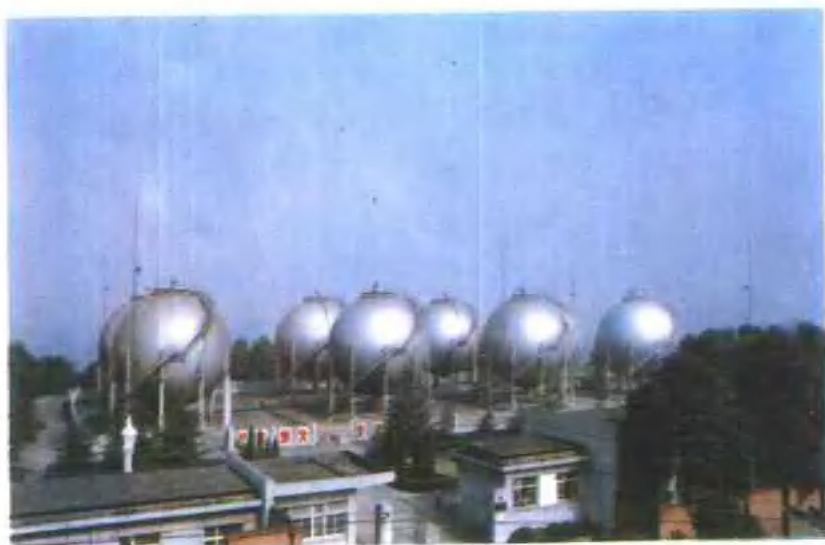
自贡市天然气公司大安储配站
