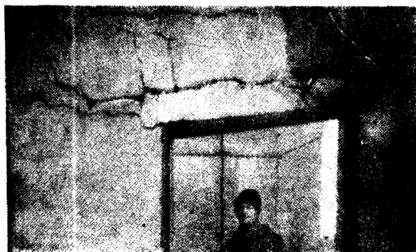
图 0.7 匈牙利一码头建筑物开裂
