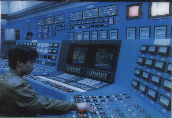
为大型电站提供配套的 DCS 控制系统
