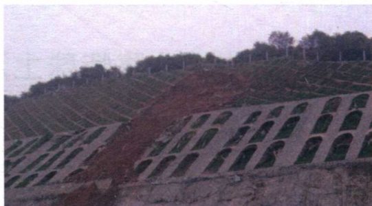
图 1.5 贵州红黏土边坡坍塌
