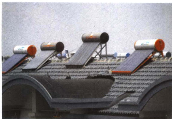
⑤安装于屋顶的太阳能装置
