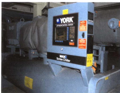
⑨安装于现场的约克牌大型冷水机组(广东中山)
