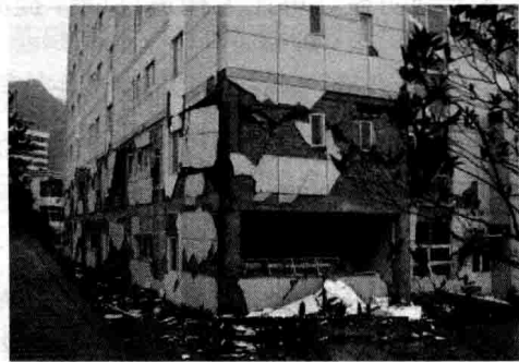
图 1-12 框架房屋填充墙破坏
