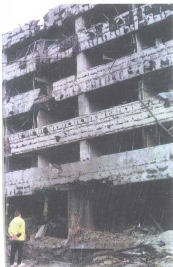
北约炸毁的中国驻南使馆馆南侧，此侧毁坏最为严重
