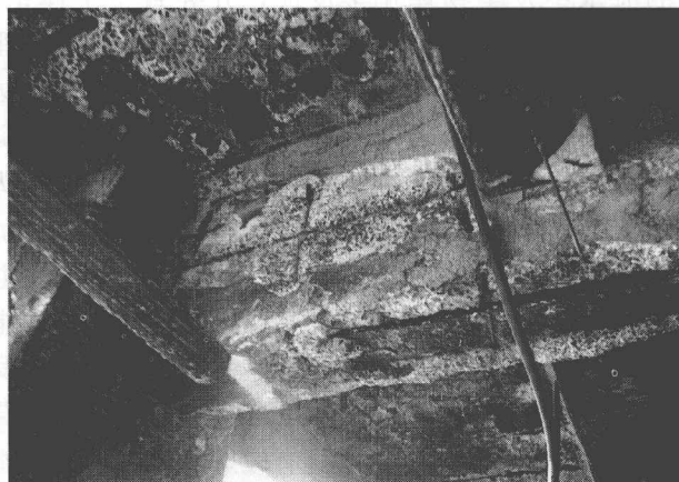
图 1.3 混凝土工程材料在海洋环境中的破坏 (由中国科学院海洋研究所拍摄)
