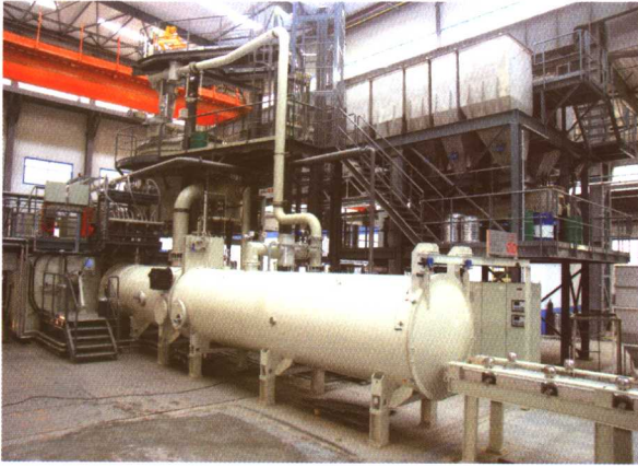
具有世界一流水平的2400kW EB炉
