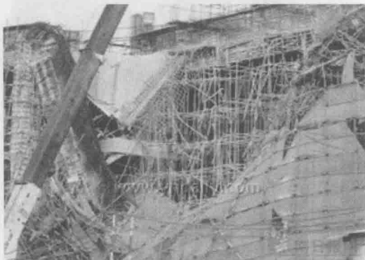
图 1.1 脚手架坍塌事故
