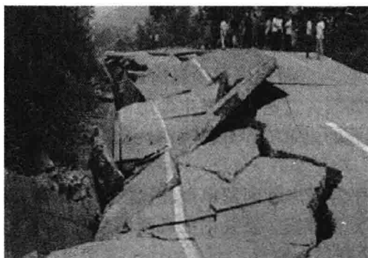
图 1.8 汶川地震的道路裂缝破坏
