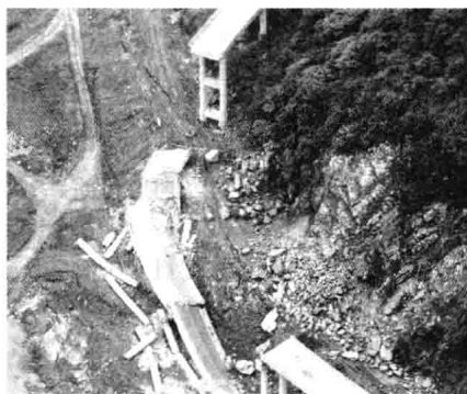
图 1.11 汶川地震引起的公路桥梁破坏
