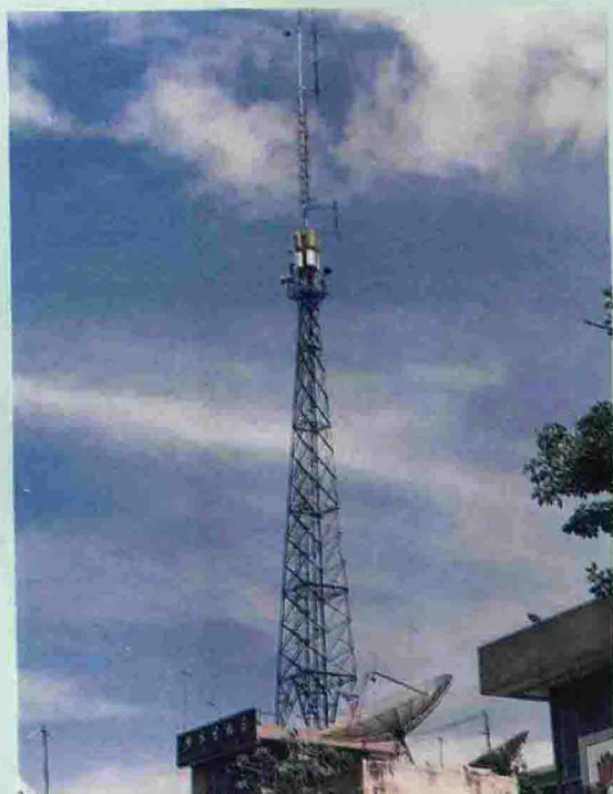
兴宁电视台发射铁塔
