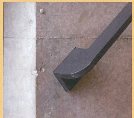
由安装在清水混凝土墙壁上 32 mm × 12 mm 的扁杆组成的扶手。
