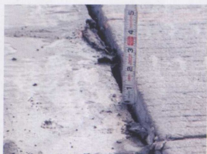
图 1-6 路面不均匀沉降错台
