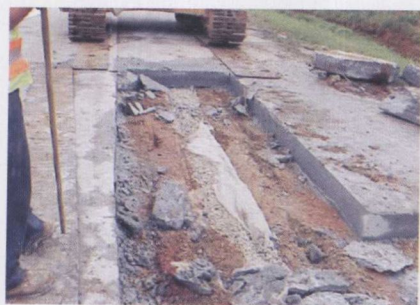
图 1-10 路肩的使用导致排水通道不畅
