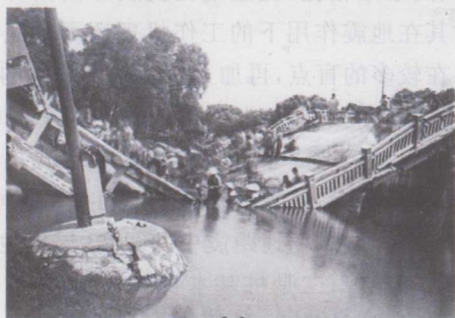
图1-1 4号墩桩基折断造成桥面垮塌
