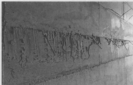
图 1.3-7 混凝土一般缺陷
