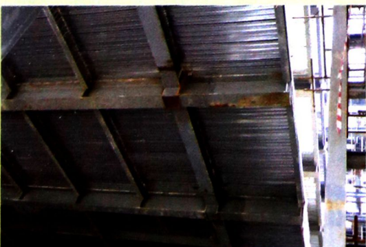
楼面采用组合楼板。钢梁上满铺压型钢板做永久模板，上面安装板的钢筋，再浇筑混凝土
