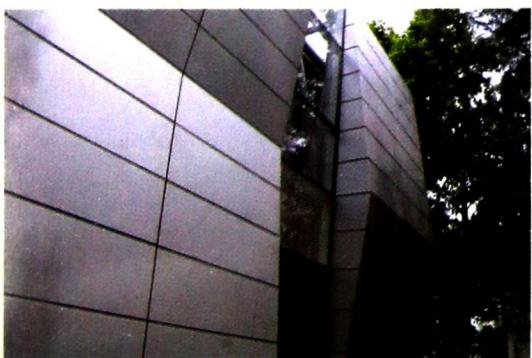
建筑外立面部分采用铝幕墙，图为正式施工前做的样板墙
