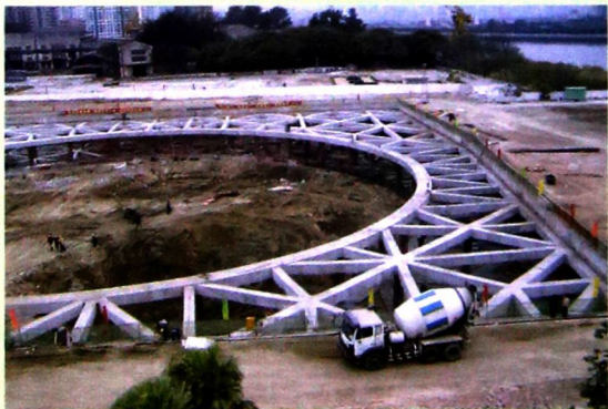
基坑由混凝土地下连续墙加三道水平环状支撑支护，支护体用逆作法施工
