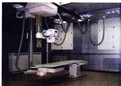
铝塑板饰面射线防护机房
