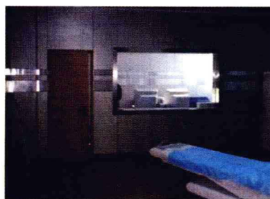
铝塑板饰面射线防护机房
