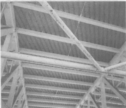
图 1.2-2 钢桁架杆件锈蚀
