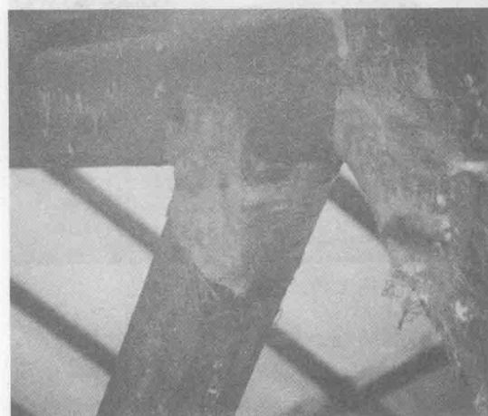
图 1.2-7 某工程屋盖结构杆件腐蚀
