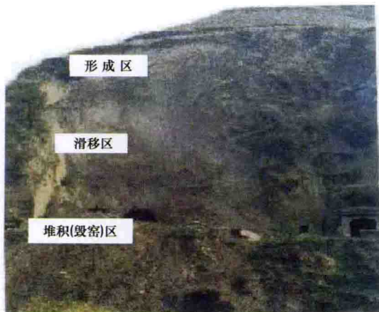
33. 张裂-滑移式黄土崩塌 (绥德县崔家湾乡顾家畔村)
