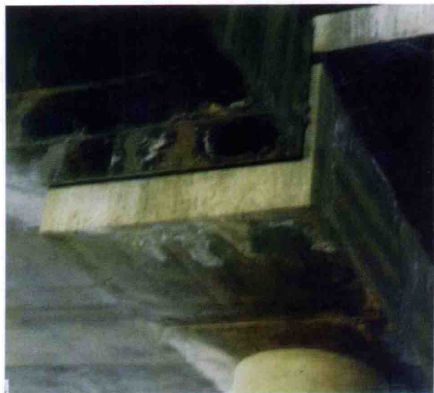
40. 西安地裂缝 ( F_6 ) 活动导致南二环路长安立交桥墩下挫, 桥面变形
