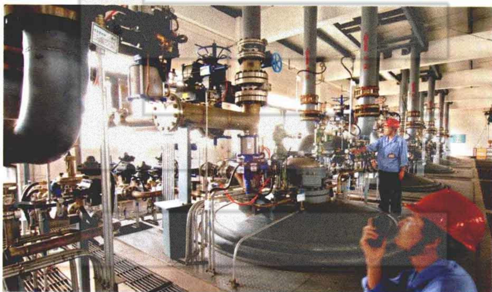
聚合釜装置现场
