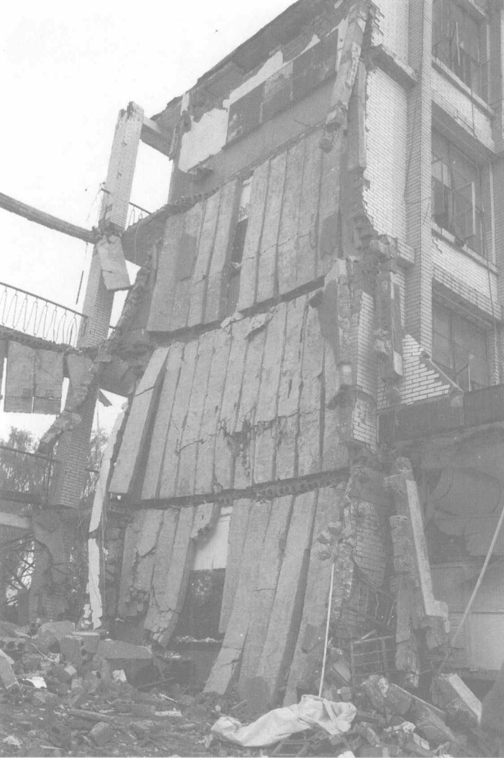
← 东汽实验中学主体坍塌的教学楼一侧墙壁，一块块预制板垂挂半空，让人触目惊心。 摄影：赵建强
