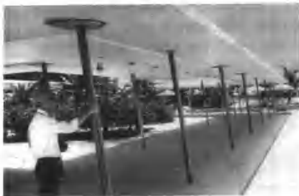
图 1.1.1 这个长廊位于委内瑞拉首都加拉加斯附近的 Macuto-Sheraton 旅馆，在 1967 年 7 月 29 日的地震中由于钢管柱变形过大而损坏。该次地震的震级为 6.5 级，饭店距震中 15 英里。(经 G. W. Housner 允许)
