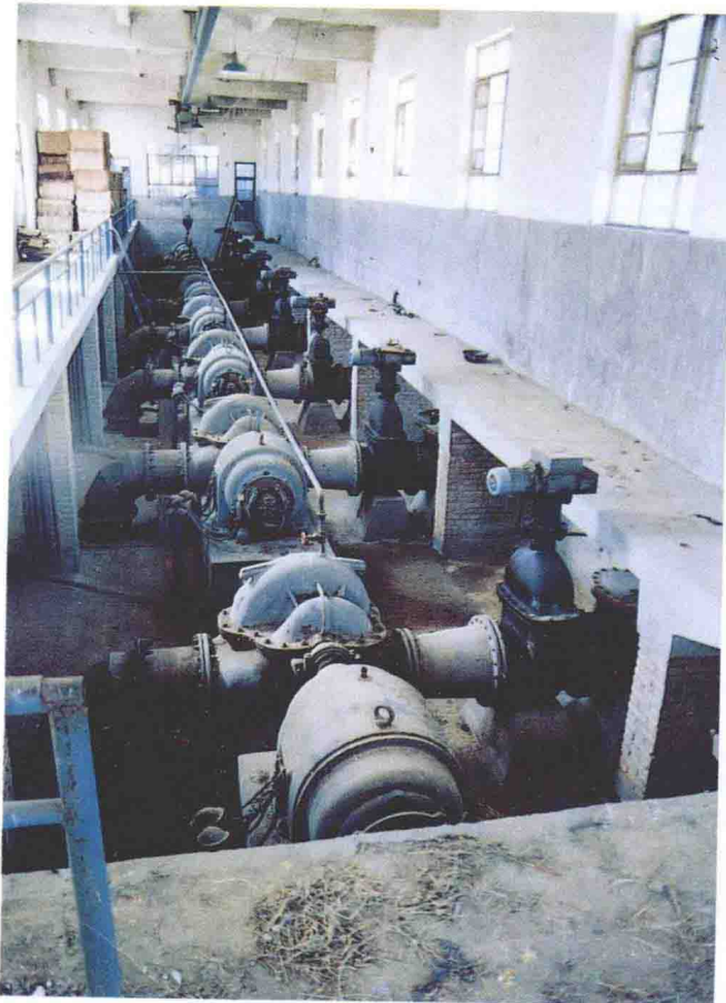
东水西调机房
