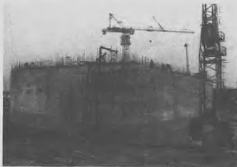
照片 1-5-1 突水涌砂, 沉井倾斜, 无法下沉
