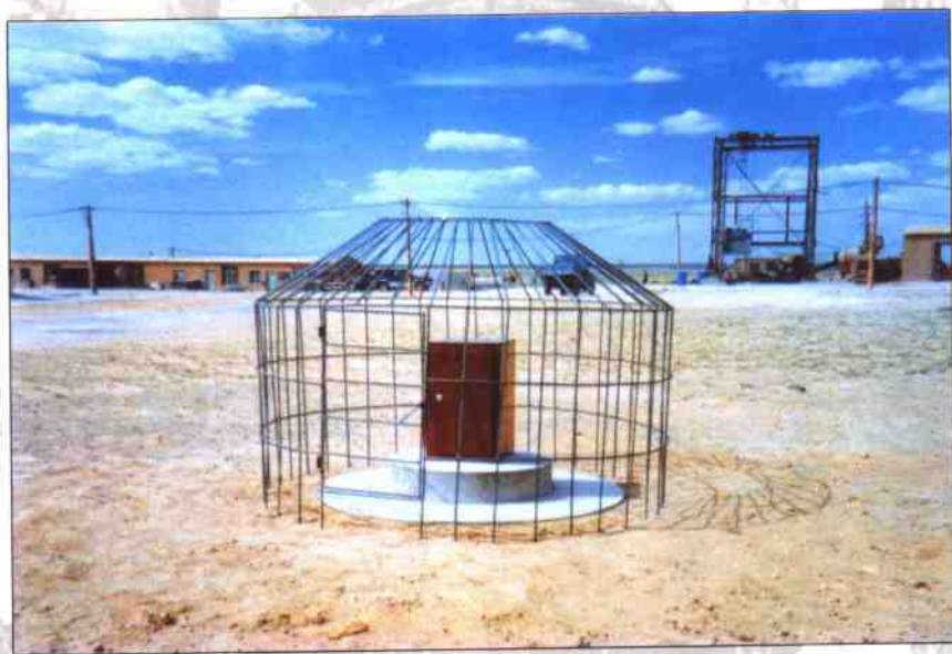
由地面造孔至隧洞顶部的多点位移计，用于测量开挖过程中的变形，指导安全施工
