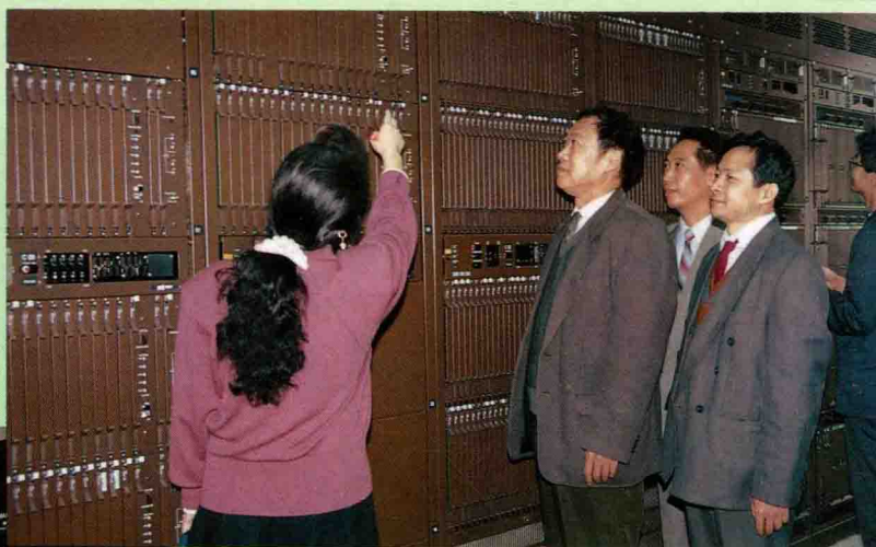
銅梁郵電局局長李中祿(左二)在程控室檢查工作 電話：(08224)632576
