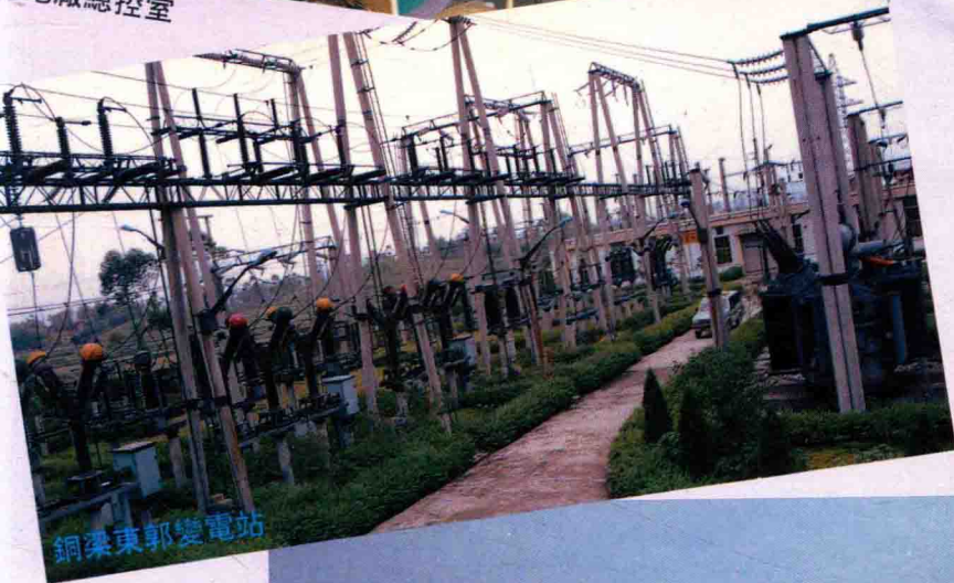
居電廠總控室
