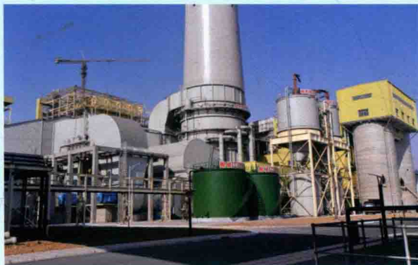
北仑电厂 2×1000MW 机组脱硫脱硝一体化装置
