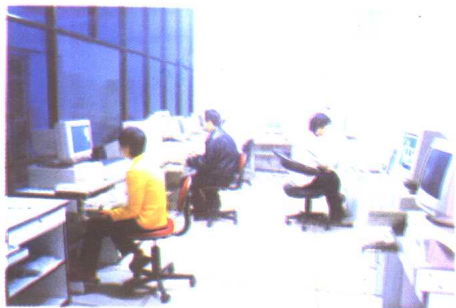
万门程控电话机房控制台
