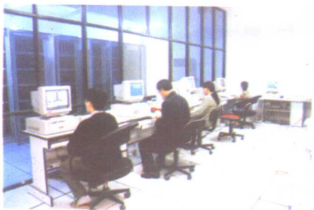
电信局程控交换室
