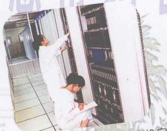
干净整洁的现代化通信生产机房
