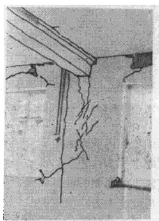
图 27 梁支座下墙体酥碎破坏
