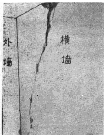
图 21 横墙在外墙外闪时受拉破坏
