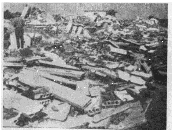
图 7 工农兵楼的倒塌
