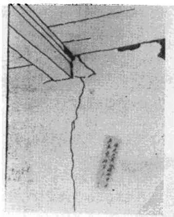
图 26 梁支座下的竖向裂缝
