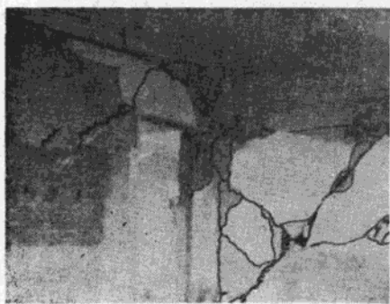
图 17 内墙的“X”形剪切裂缝、
