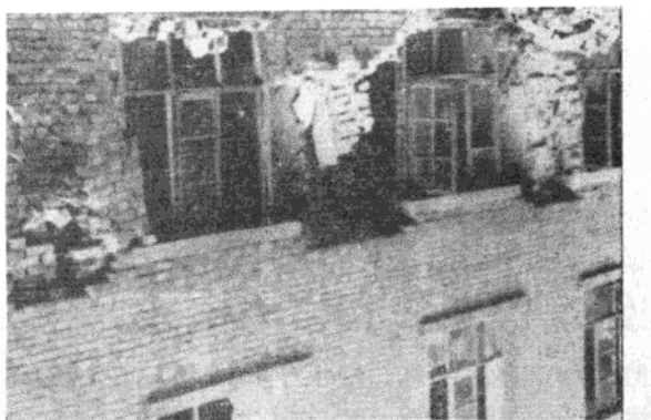
图 6 西山路开漆工房底层砖墙的破坏
