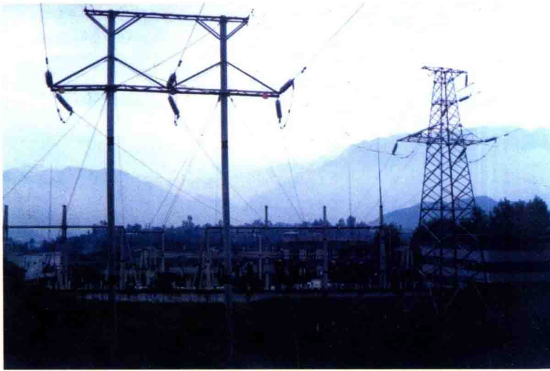
印江自治县最大的扶贫项目—玉印输变电工程一角
