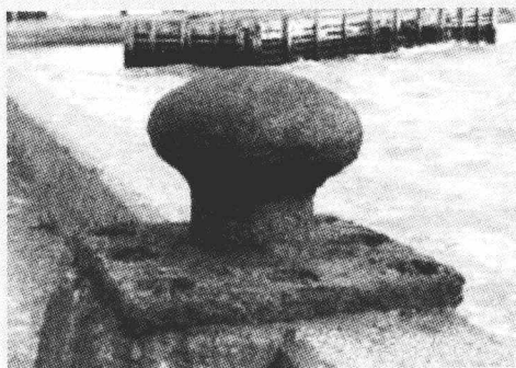
图 1.4 金属工件腐蚀
