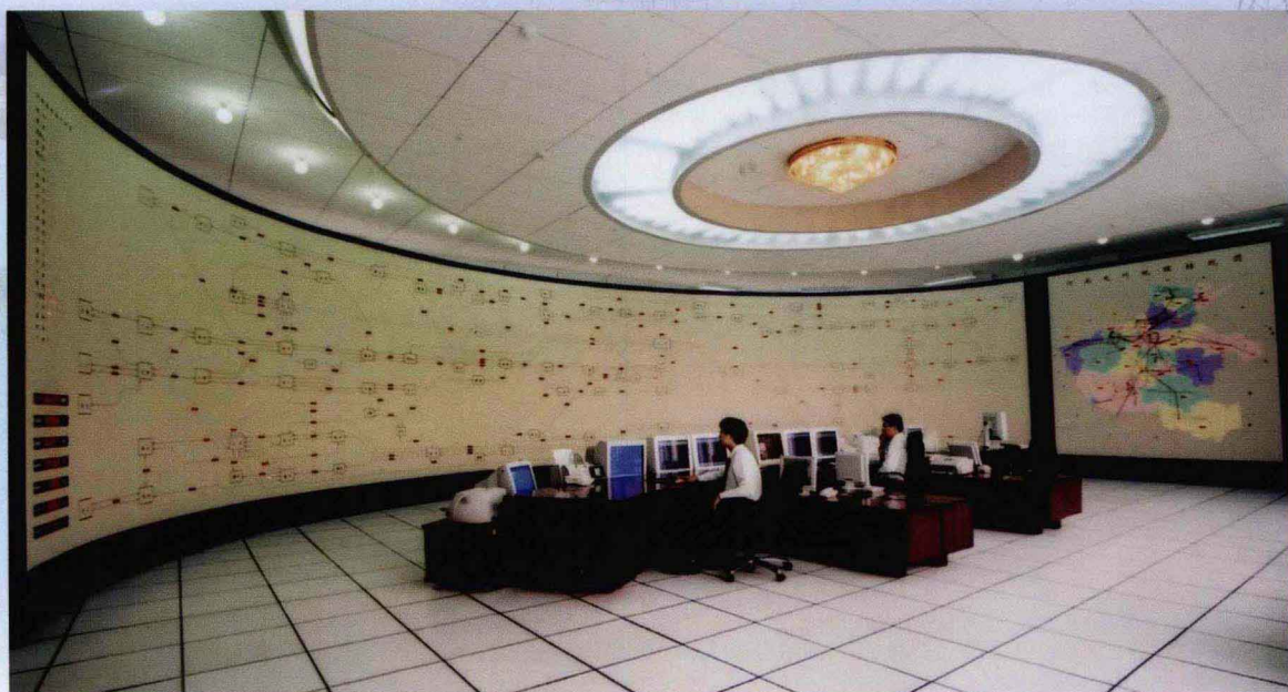
河南省电力中心调度室
