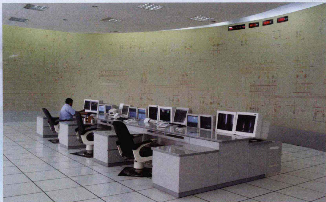
平顶山供电公司电力调度室
