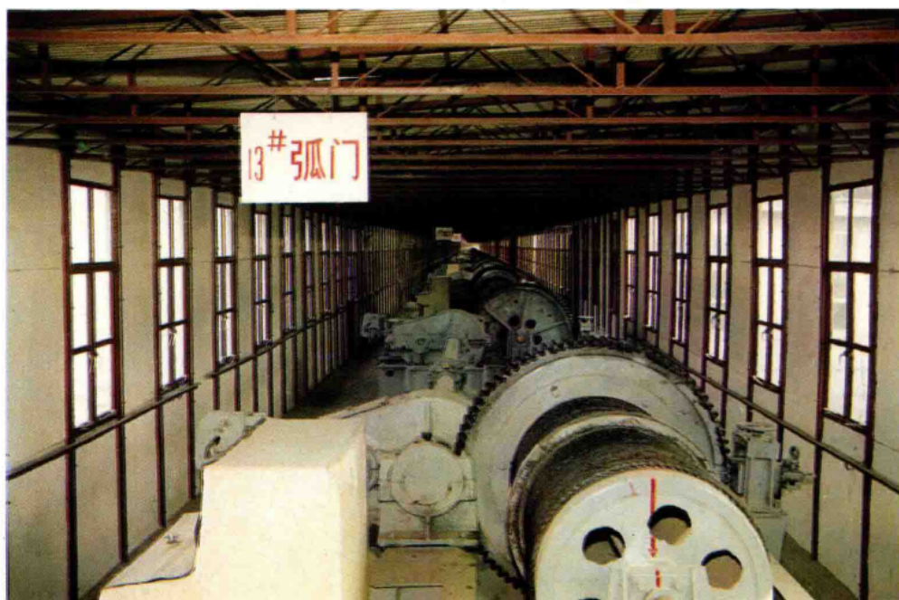
防洪设备启闭长廊
