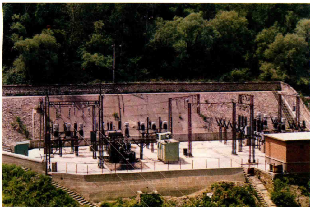
发电厂变电站
