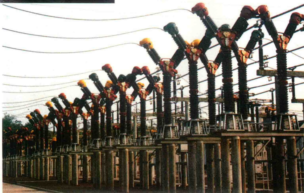
220kV东新村变电站
