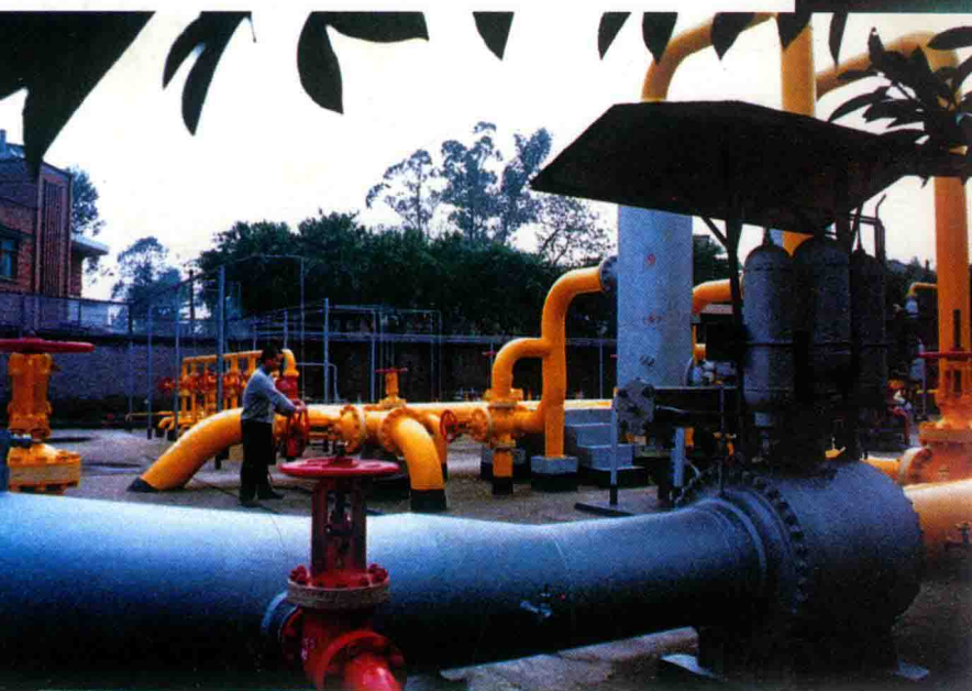
天然气配气系统
