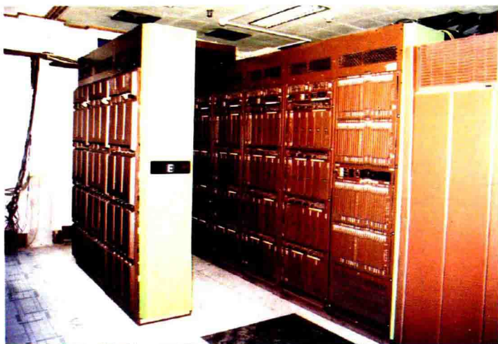
巴川镇中兴路100号云龙电信机房C&C08程控交换设备。
