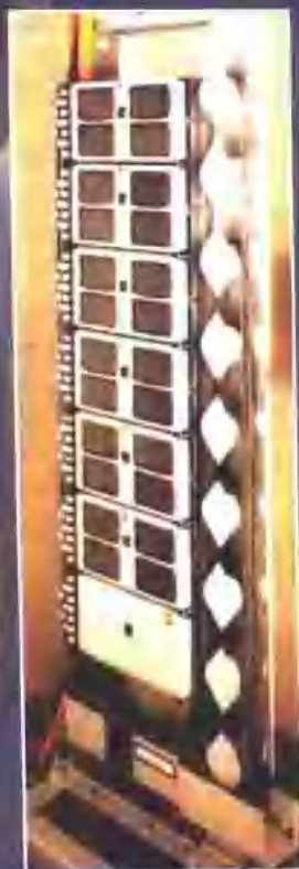
光配线架和中间配线盘
